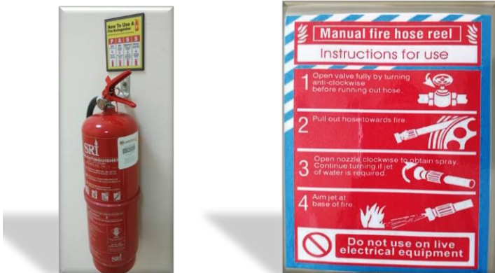
Peralatan Pencegahan Kebakaran
